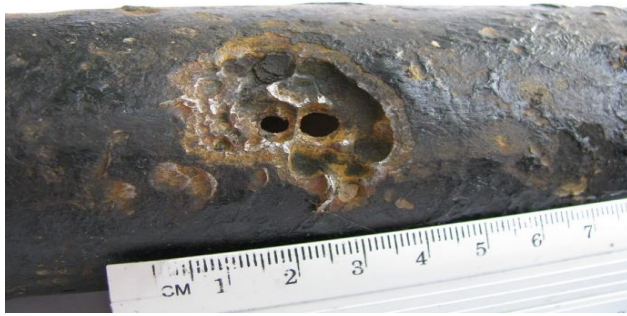
Рис. 1. Пошкодження труби газопроводу низького тиску внаслідок електрокорозії. Fig. 1. Electrocorrosion damage of low-pressure gas pipeline.
